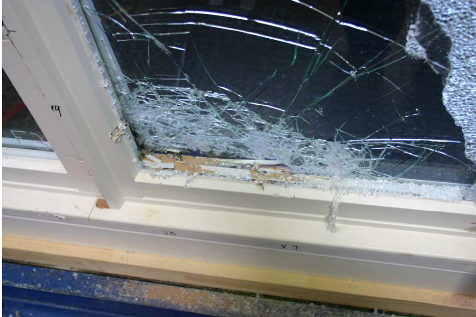
Bild 8 Schäden aus der manuellen Prüfung der Glasanbindung
