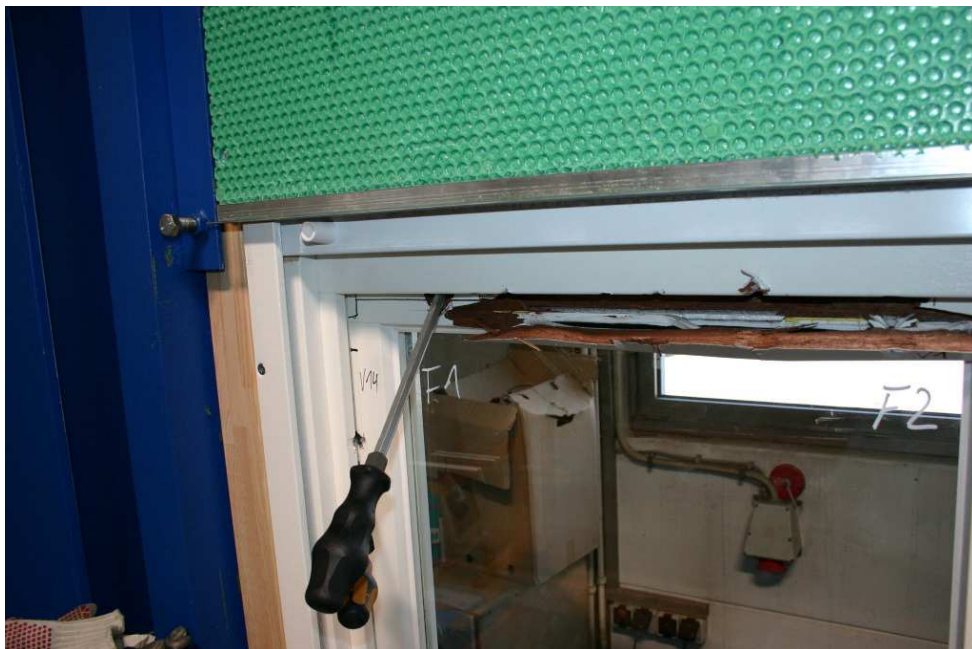
Bild 7 Schäden aus der manuellen Prüfung am Scherenlager
