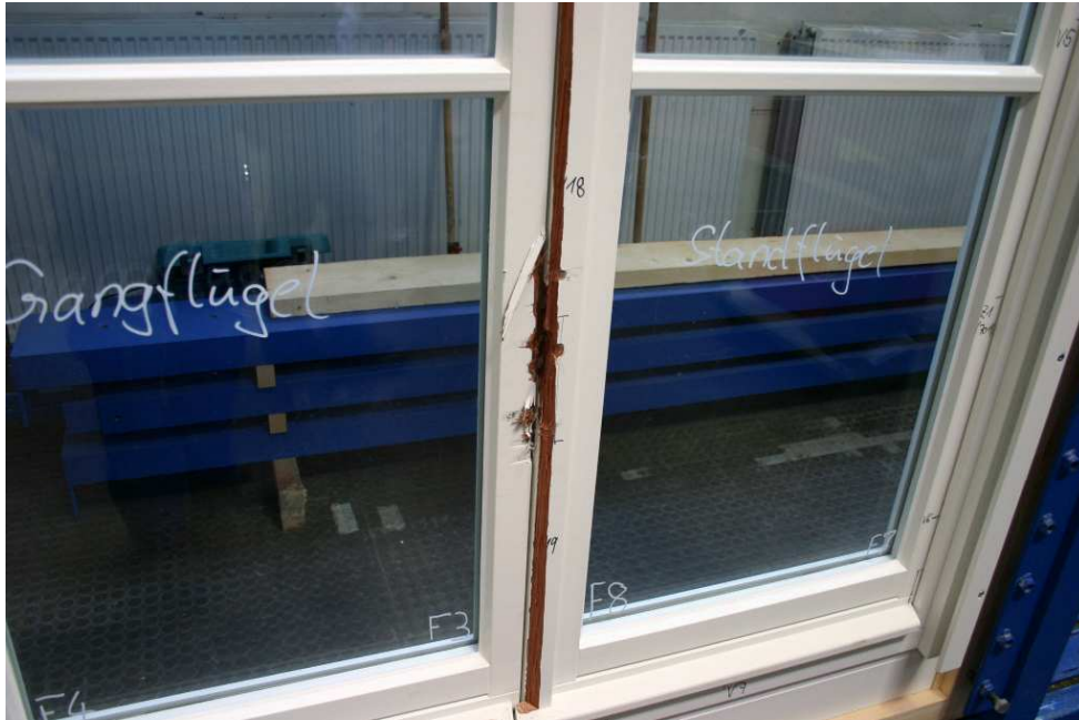
Bild 4 Schäden aus der manuellen Prüfung am Stulphebel
