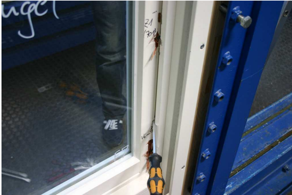
Bild 6 Schäden aus der manuellen Prüfung am Ecklager
